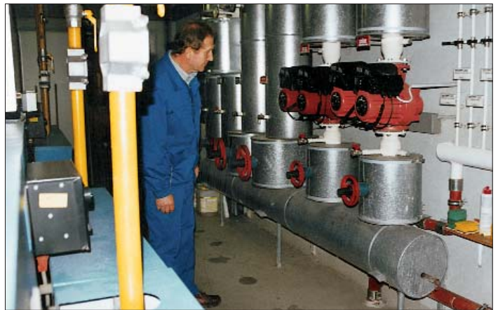
Die Kontrolle der Heizzentralen gehört für Hausmeister Joseph Knott zum täglichen Rundgang in der Haarer Gartenhofsiedlung. Foto: cws
