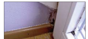
Schimmel – hier in einer Wohnung in Haar – vermeidet dauerhaft nur richtiges Lüften E.: bwv
